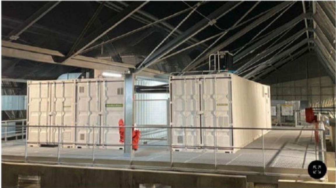
Methaniseur BioBeeBox sur le toit du centre commercial Les Terrasses du Port de Marseille. (Biobeebox)
